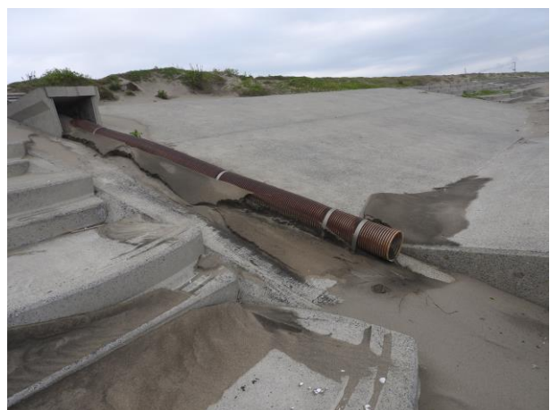
図 6 3 排水口の状況①
