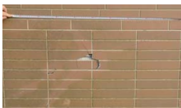
陥没した野榮ふれあい公園のトイレ棟外壁
