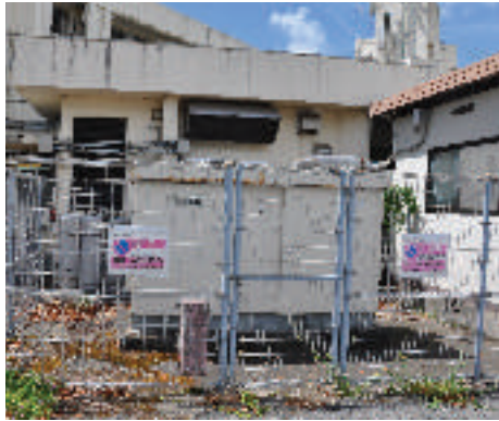
市役所敷地内設置の非常用発電設備
