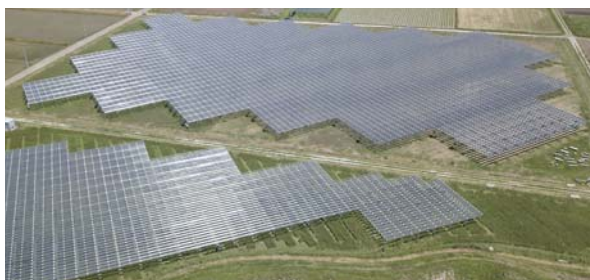
豊和地区にある匝瑳メガソーラーシェアリング第一発電所
