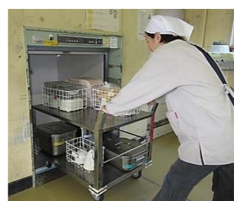
ワゴンと専用エレベーターに乗せて2～4階まで運びます
