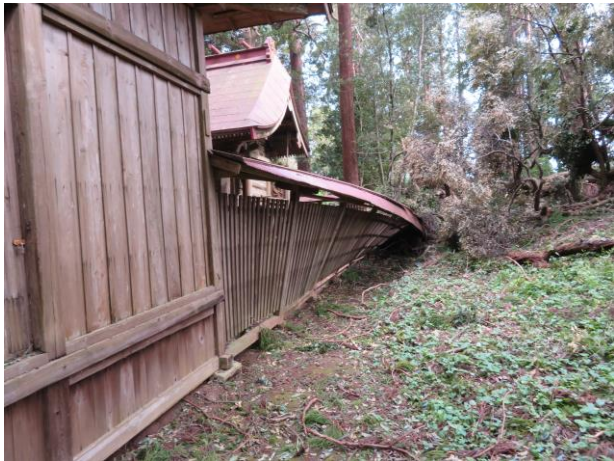
(玉垣被害状況)
