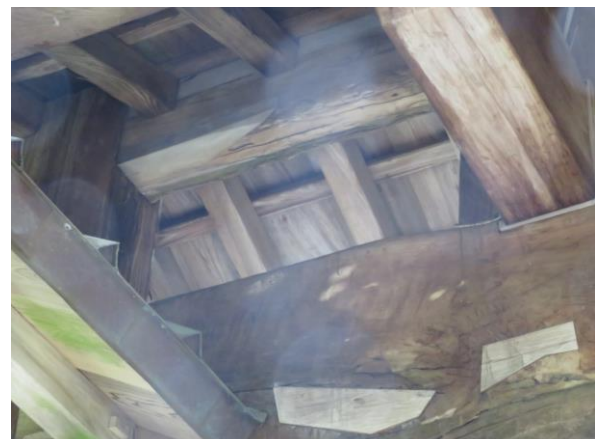
(総門被害状況)
