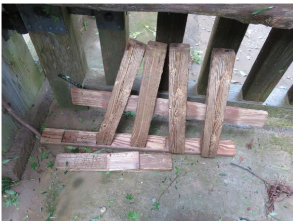
(総門被害状況)
