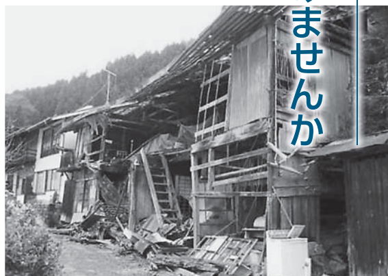
放置された空き家 (出典 国土交通省住宅総合整備課「空き家の現状と問題について」)
