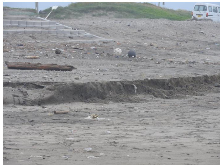
画像3 防潮堤の下の砂浜。砂が侵食でえぐり取られ、浜崖(30cm～40cm)が形成されている。
