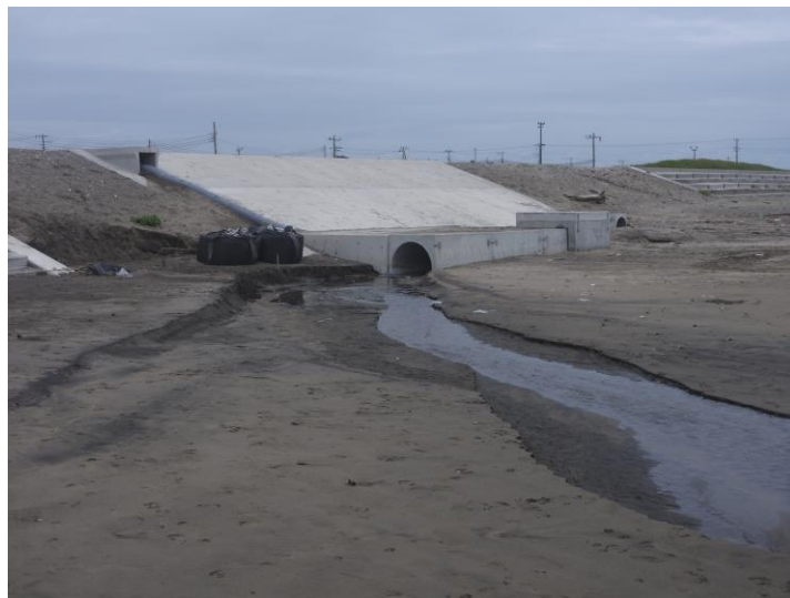
画像2 排水管からの排水が海水浴場に流出している。
