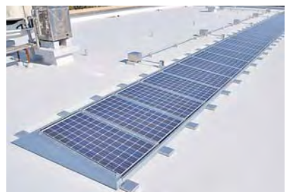
生涯学習センター屋上に設置した太陽光パネル
