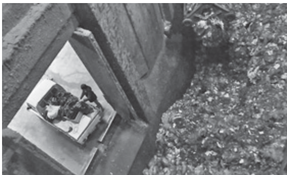
松山清掃工場のごみピット(操作室から撮影)。ごみ収集車両だけでなく、連日多くの一般車両がごみ搬入に訪れる
