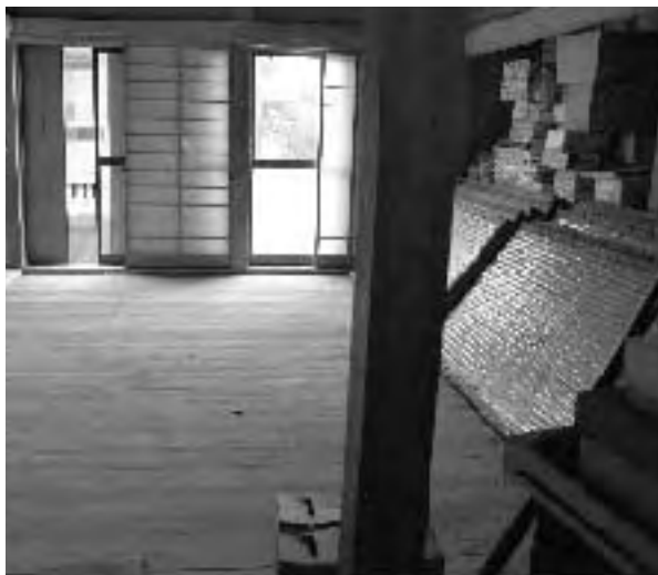
▲ ④津波による床上浸水被害の住宅(今泉)
