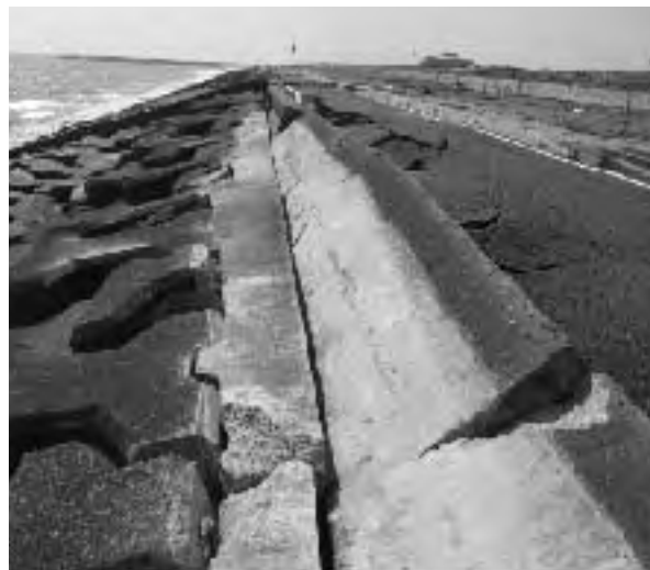
▲ ⑧津波で破壊された緩傾斜護岸(野手浜)
