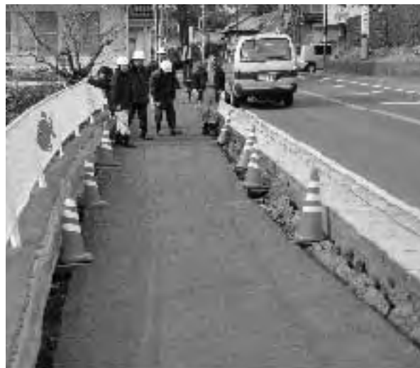
▲ ⑤地盤沈下した歩道(田町)
