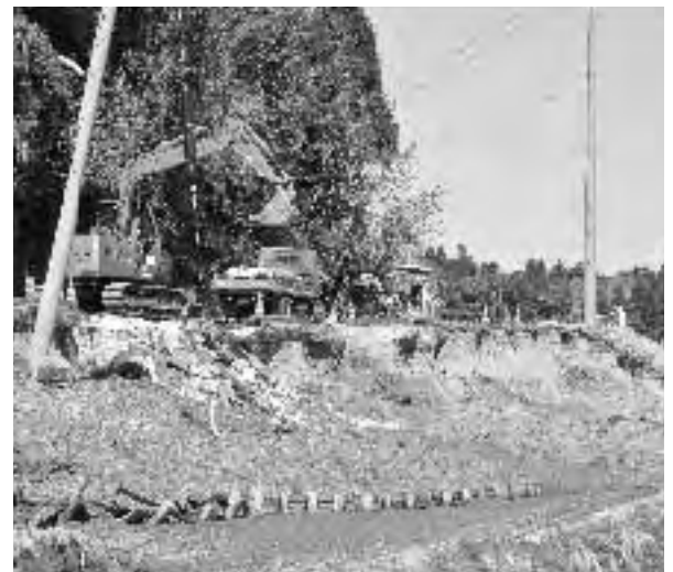
▲ ⑥路肩の崩落(米倉)
