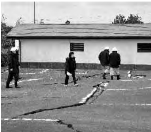
▲ ①ひび割れた駐車場(吉崎浜野外活動施設)
